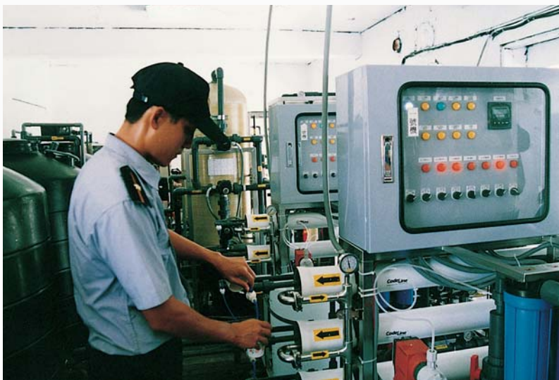
▲海水淡化製造機
