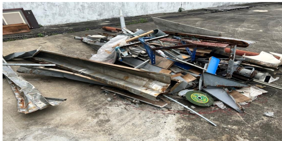
豐里報廢區廢棄材料照片
