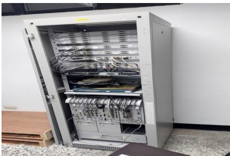
交換器、伺服器、控制器、通信介面 控制器
